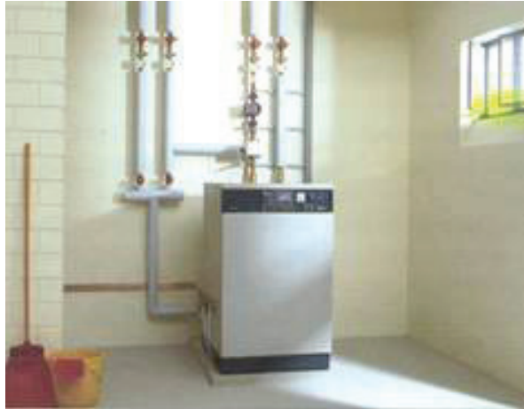
Fig. 7.13. Një central termik ku është aplikuar termorregullimi me valvule përzierëse të kontrolluar automatikisht.
